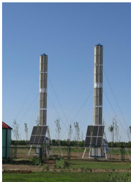
Рисунок 4А – Два ВВТ (ВРТБ) по 5 кВт для резервного питания объекта «Лесной кордон», Акмолинской области
