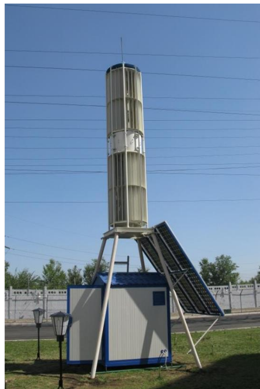
Рисунок 2А - ВВТ (ВРТБ, 2,5 кВт) на площадке ТОО «Машзавод»
